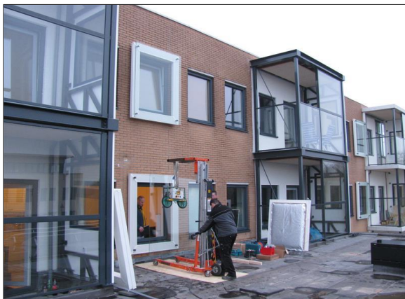
Foto II.1 Aanzicht glazen gevelgeluidschermen
